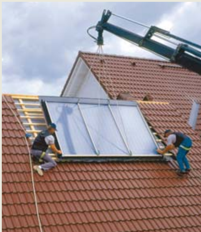
Obr. Solární kolektory pro integraci do krytiny se montují pomocí jeřábu. Montáž je tak velmi rychlá. Nainstalování kolektoru trvá max. 1 hodinu.
