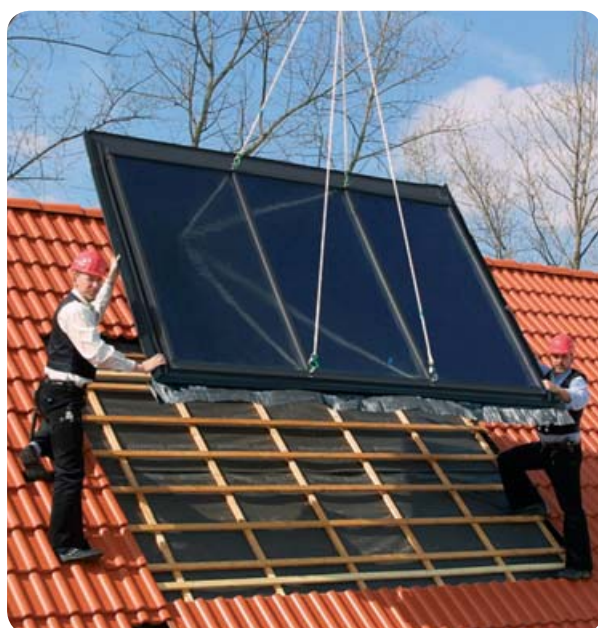
Obr. Solární kolektory pro integraci do krytiny se montují pomocí jeřábu. Montáž je tak velmi rychlá. Nainstalování kolektoru trvá cca 1 hodinu.
